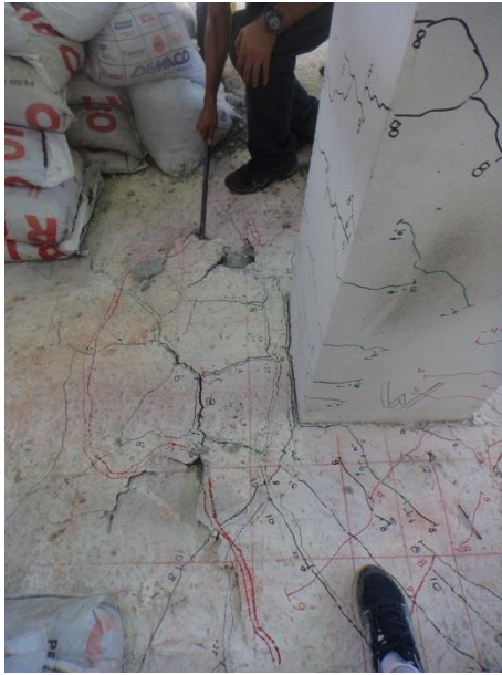
Figura 10. Losa agotada alrededor de la columna.
