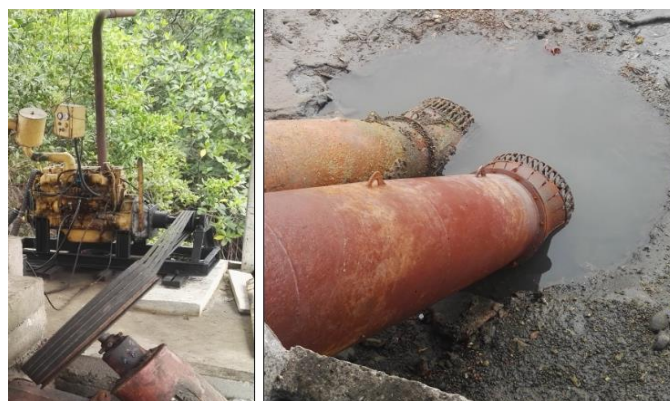
Figura 3. Estación de bombeo diésel de una camaronera
