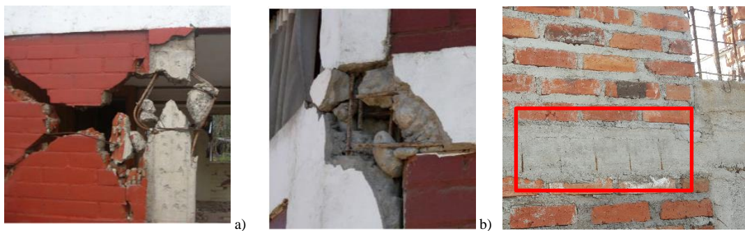
Figura 4. Fallas por mal detallado del refuerzo: a) Falla por cortante y pandeo del refuerzo longitudinal debido a separación de estribos excesiva en los extremos de la columna de confinamiento; b) falla por discontinuidad de refuerzo longitudinal (Tomado de Brzev et al., 2010), y c) exposición del refuerzo debido a recubrimiento inadecuado en una edificación en Cuenca.
