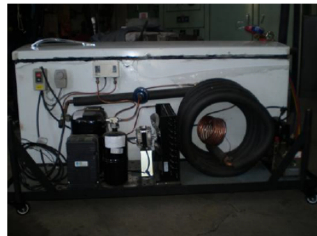
Figura 10. Vista frontal del sistema de Refrigeración.
