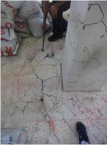
Figura 10. Losa agotada alrededor de la columna.
