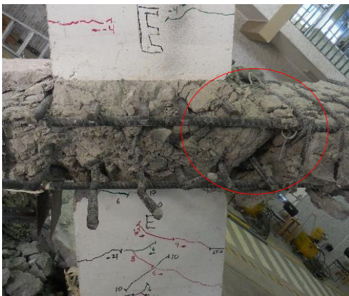
Figura 11. Efecto del corte de la losa debido a la falla por punzonamiento.
