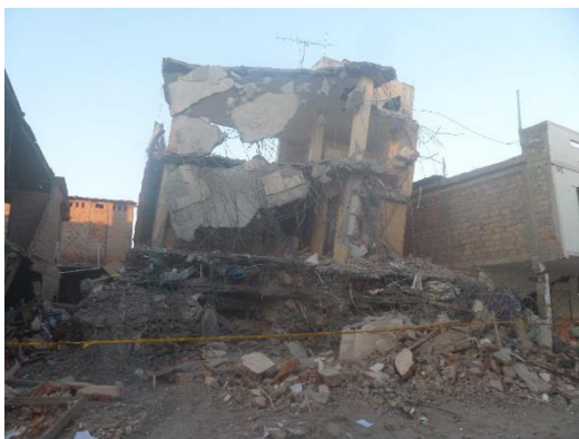
Figura 2. Vivienda con vigas embebidas en Manta afectada por el terremoto del 16 de abril de 2017.
